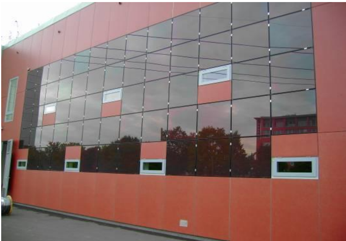
RTP Litostroj v Ljubljani – sončni moduli so vkomponirani v del fasade. Lahko bi sončni moduli zajemali tudi celo fasado.
